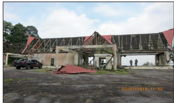
Ampang Look Out Point - Atap Hilang (02.07.2019) (Sumber: Jabatan Audit Negara)
