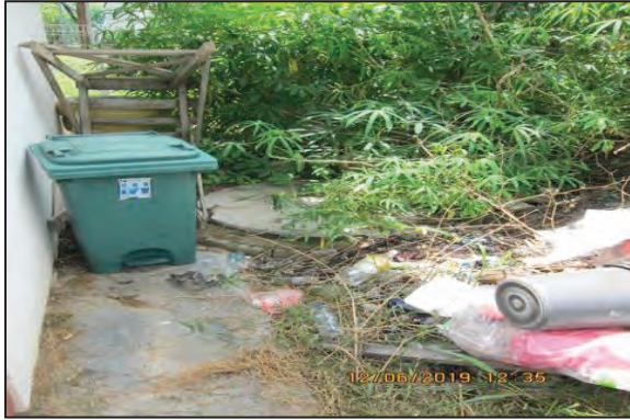
Kolam Air Panas Batu 16, Dusun Tua - Manhole Tidak Dibina (Keadaan Asal Belakang Tandas) (12.06.2019) (Sumber: Jabatan Audit Negara)
