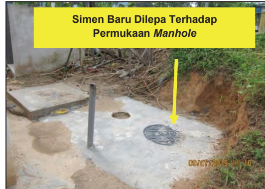
Kolam Air Panas Batu 16, Dusun Tua - Manhole Dibina Selepas Teguran Audit (09.07.2019) (Sumber: Jabatan Audit Negara)
