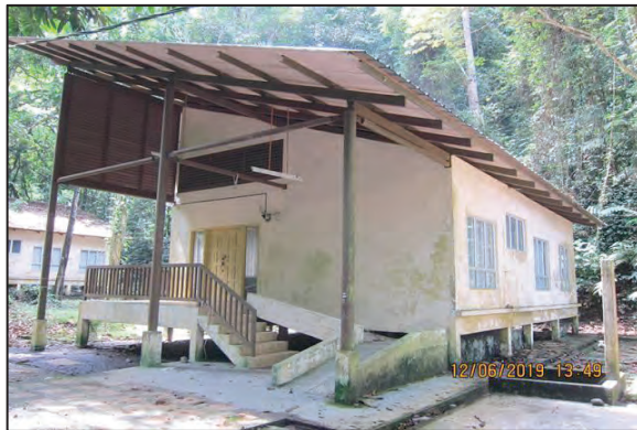
Congkak Park & Resort - Dinding Chalet Berlumut dan Kotor (12.06.2019) (Sumber: Jabatan Audit Negara)
