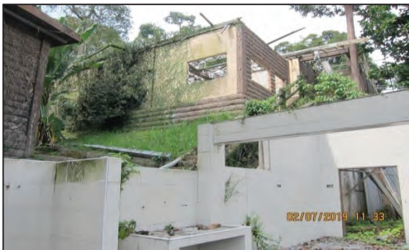
Ampang Look Out Point - Bangunan di ALOP Telah Roboh (02.07.2019) (Sumber: Jabatan Audit Negara)
