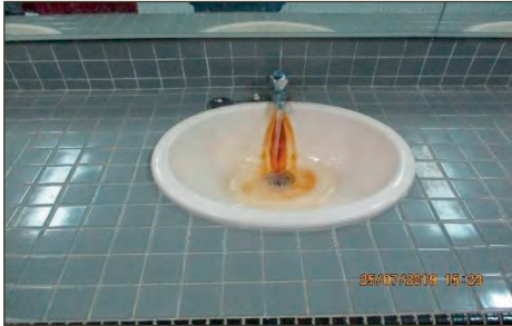
Stadium Shah Alam, Tandas Tingkat 3 - Paip Rosak dan Air Sentiasa Mengalir (25.07.2019) (Sumber: Jabatan Audit Negara)
