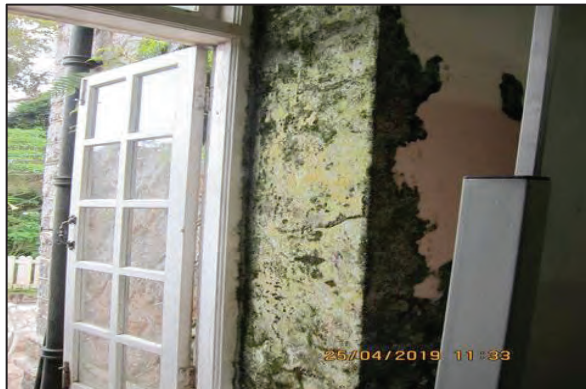
Rumah Rehat Seri Berkas - Dinding Berlumut Disebabkan Kebocoran Sistem Perpaipan (Sumber: TSSB)
